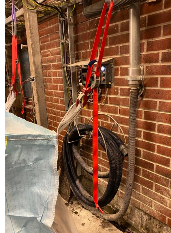
Seinän takaa löytynyt imurin liitântä
